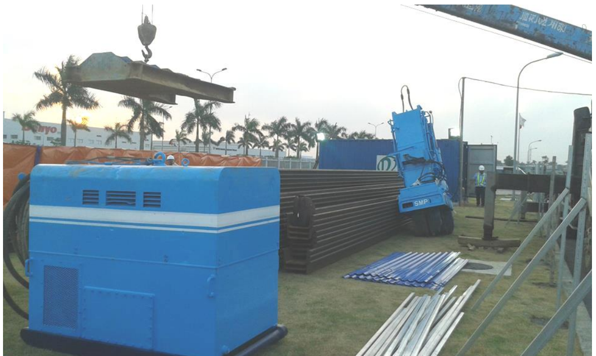
Máy phát điện
